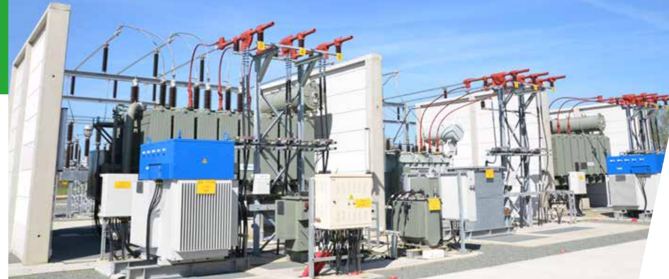
Un nouveau poste de transformation pour Champdeniers.
